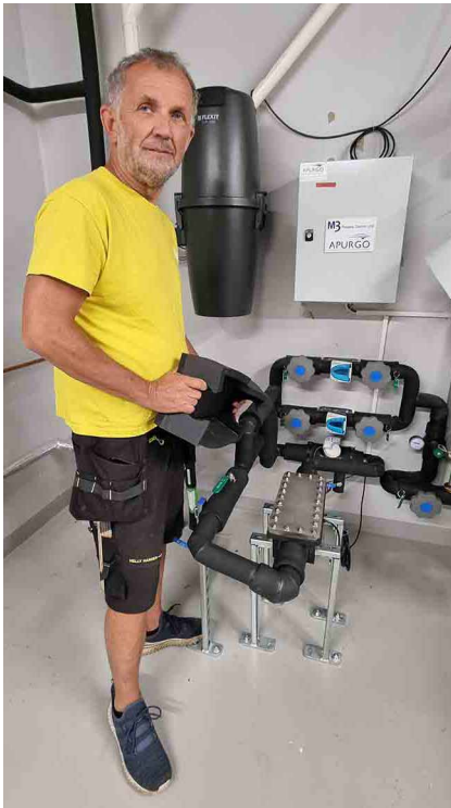
Kjell Jensen i Bolig Drift foran nylig installerte ApurgoM3-Mini. Foto: Apurgo
